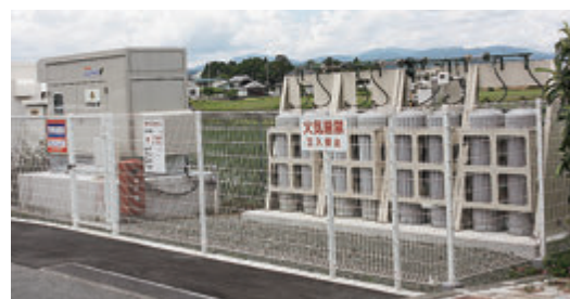
防災型非常用発電設備 (2018年度)
